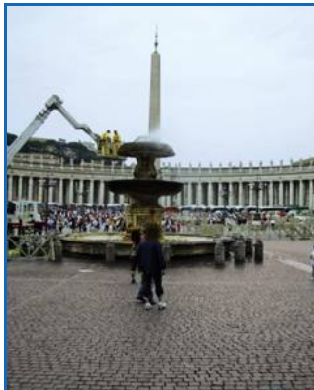
▲ Figura 6 - Esempio di intervento manutentivo senza adeguati DPI
