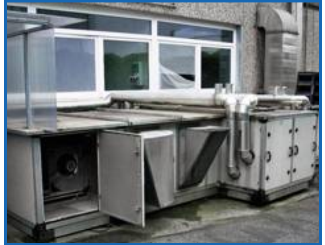
▲ Figura 3 - Esempio di Unità di trattamento aria (UTA)
